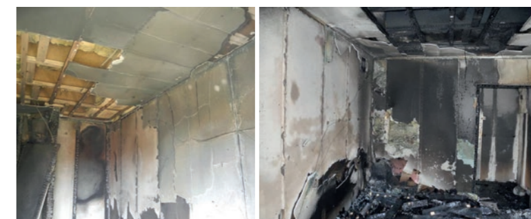
Fot. 10. Widok przykładowych pomieszczeń po pożarze. W celu oceny konstrukcji część okładzin została zerwana podczas akcji gaśniczej
